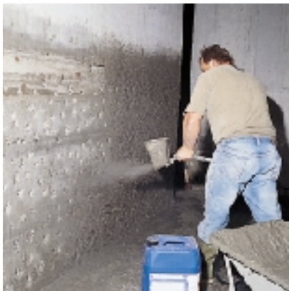
Application par projection de la première passe adjuvantée avec le LIQUIDE IDROSILEX
